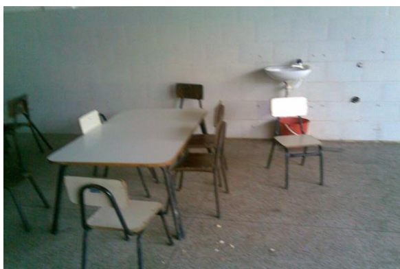
Figura 1 - Higiene deficiente do refeitório e rede hidráulica defeituosa
