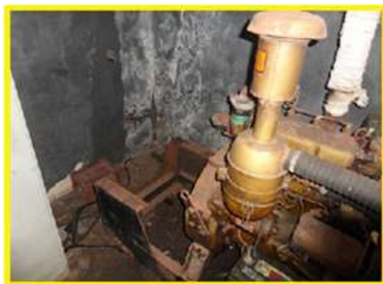
Figura 43 – Gerador danificado encontrado em condomínio vertical. Aracaju. Fonte: O Autor
