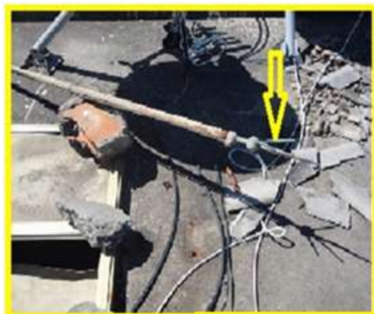
Figura 20 – Haste do para-raios danificada Fonte: o Autor
