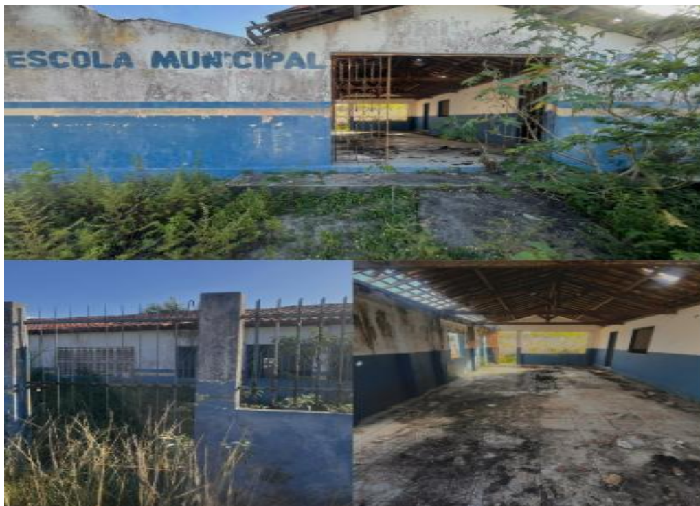
Figura 7 – Prédio escolar em estado de abandono, Rio Real/, 2024
