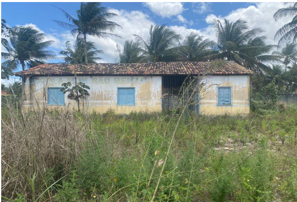
Figura 8 – Prédio da Escola Mun. São Bento, Rio Real/BA, em estado de abandono
